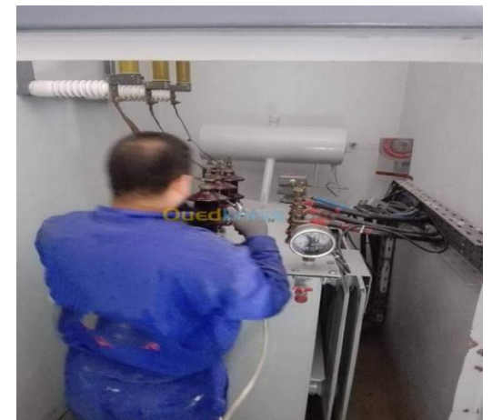
[Entretien préventif poste transformateur]
