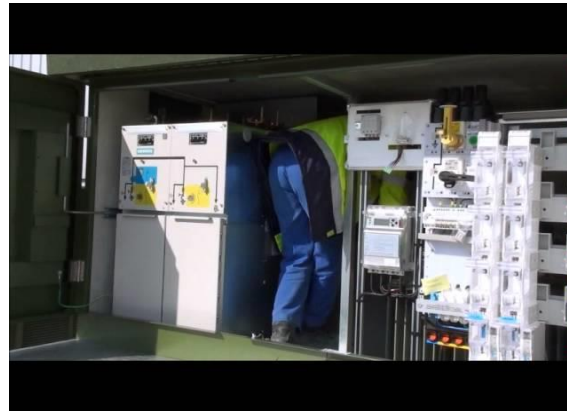
[entretien préventif cellules de protection transformateur]
